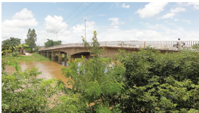
Ponte a ser recuperada no Rio Mearim
