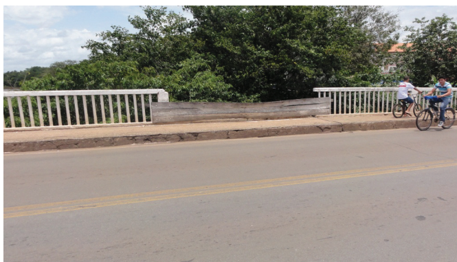
Ponte a ser recuperada no Rio Mearim
