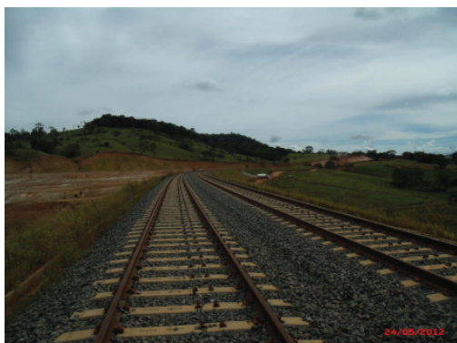
Desvio de Cruzamento no Lote S/N e obras do entroncamento com a Extensão Sul
