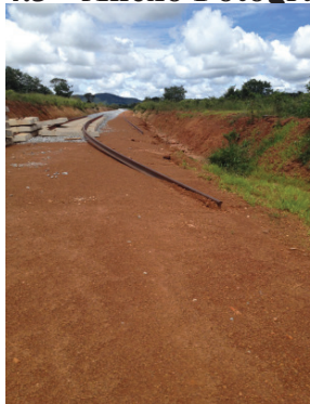
Aterro executado em desconformidade com as normas técnicas vigentes - Lote 11
