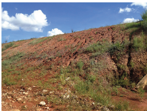
Aterro executado em desconformidade com as normas técnicas vigentes - Lote 10
