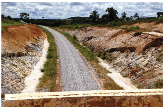
Erosão de Talude - Lote 11
